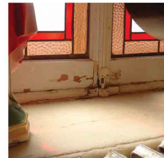
Fig. 89 : La plupart des fenêtres intérieures de la sacristie sont en mauvais état.
