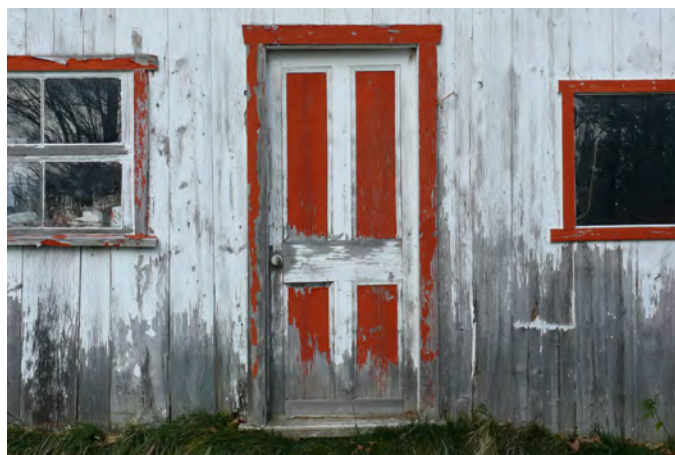
Porte piétonne à panneaux sur un bâtiment situé au 7191, route Marie-Victorin, à Lotbinière.
