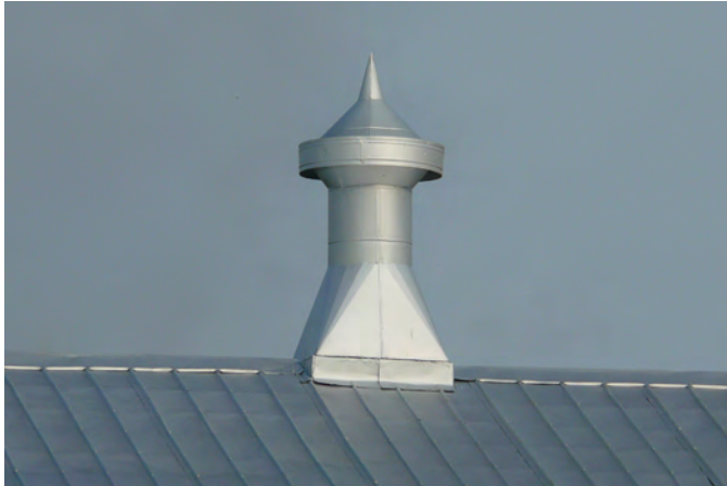
Évent métallique sur une grange-étable située au 345, rang Bois-Franc Est, à Notre-Dame-du-Sacré-Cœur-d'Issoudun.
