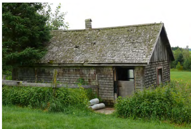
Bâtiment laissé sans peinture ni teinture situé au 205, route Beaurivage, à Saint-Patrice-de-Beaurivage.
