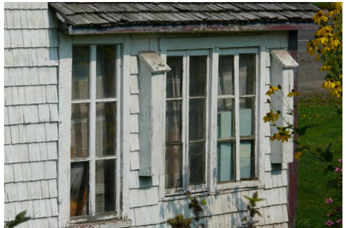
Évents permettant de ventiler l'intérieur d'un poulailler situé au 384, boulevard Saint-Joseph, à Laurier-Station.
